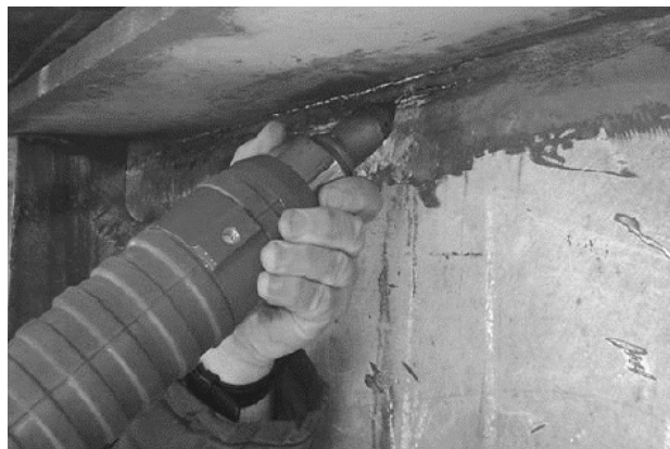
写真5 橋梁スパンの溶接部に発生した疲労き裂補修部の拡大図（溶接とUP処理）
