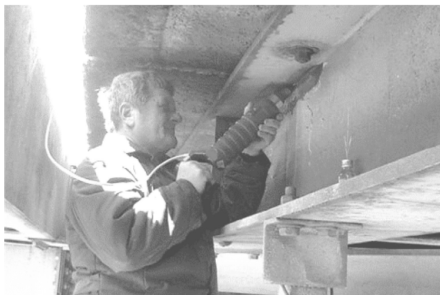
写真4 橋梁スパンの溶接部に発生した疲労き裂の位置とき裂補修時のUP処理状況
